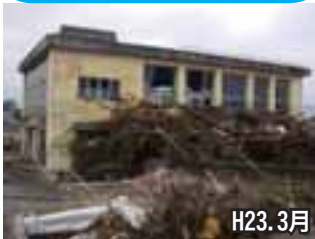
相の釜排水機場
