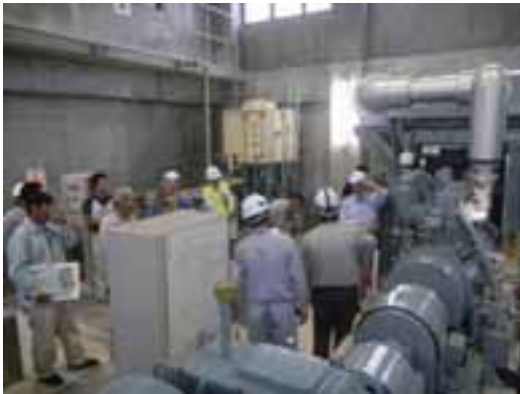
閑上排水機場(操作説明会の様子)
