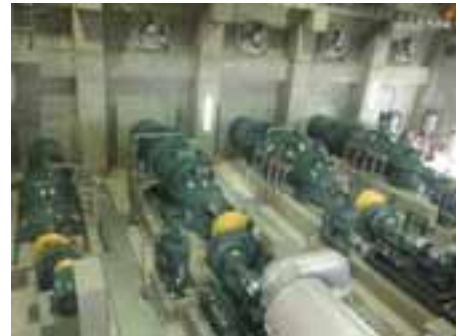
寺野排水機場(内部の様子)
