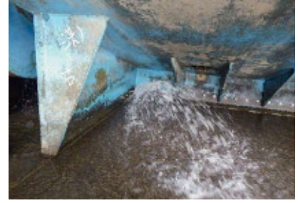
NO.1 洪水吐ゲートの漏水
