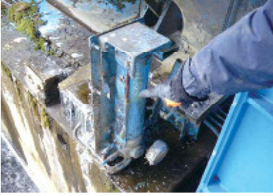
外部給油装置の動作不良
