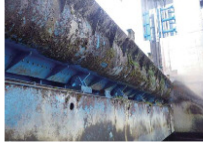
土砂吐ゲート塗装の劣化
